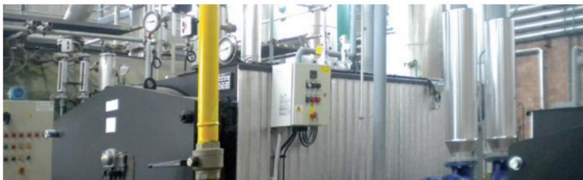
• Centrale Termica (Giugliano di Napoli)
