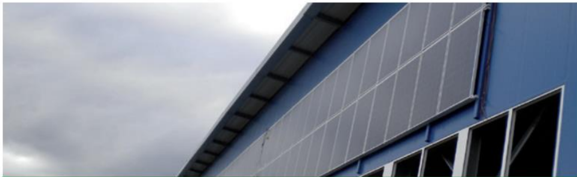
• Impianto Fotovoltaico (Venticano)
