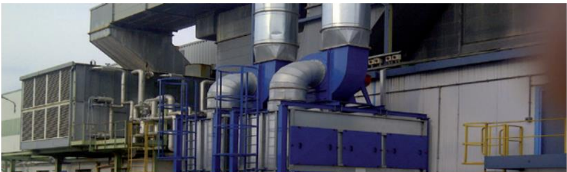
• Impianto filtri a carboni attivi (Pomigliano D'Arco)
