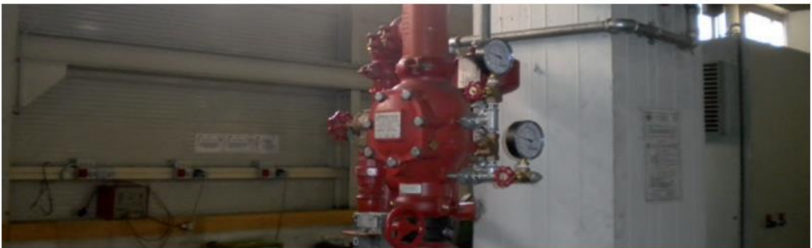
• Impianto Antincendio (Caserta)
