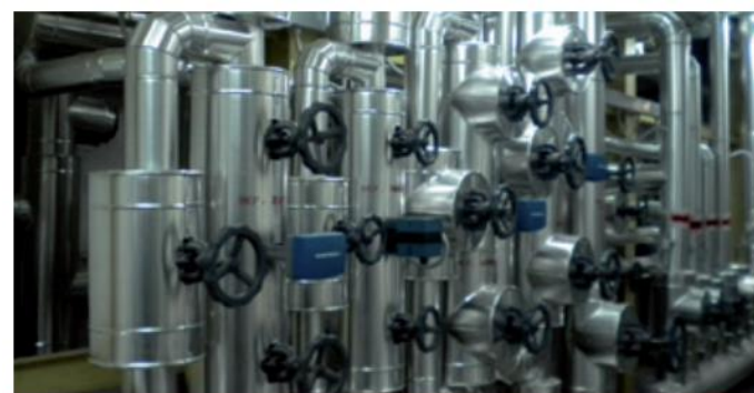
• Centrale Termica (Cisterna di Latina)
