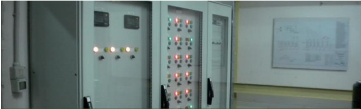
• Quadro Elettrico Centrale Termica (Cisterna di Latina)
