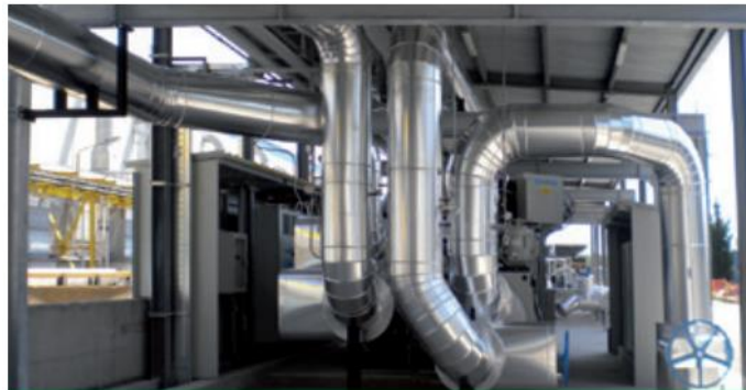
• Centrale Frigo (Nola)
