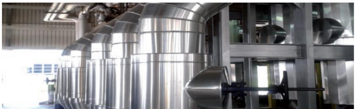
• Centrale Termica (Nola)
